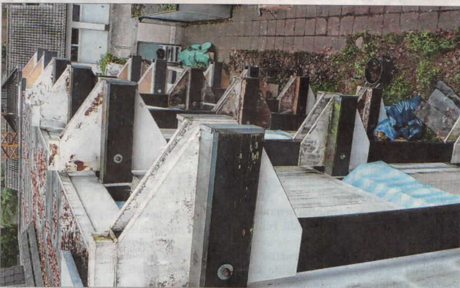
Auf den ersten Blick sind die Schäden erkennbar, die das Haus Mayer-Kuckuk durch Wind und Wetter davongetragen hatte.
